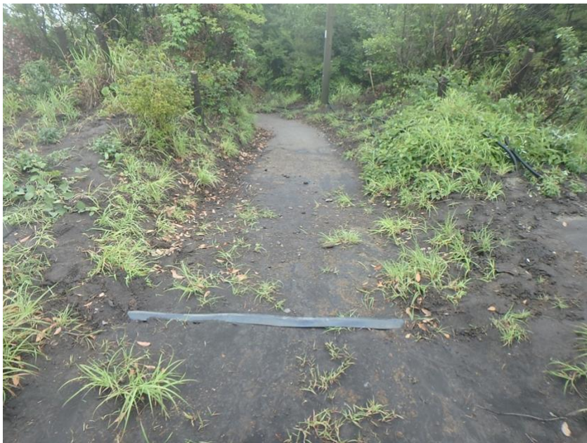
図 59 地震計室へ行く道の上を配線した光ケーブル.
